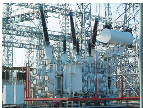
Электрические сети Электростанции, подстанции, линии электропередач
