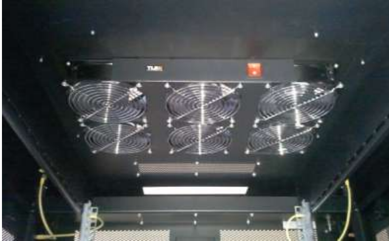
Установленный вентиляторный блок TLK-FAN6-BK в шкафу
